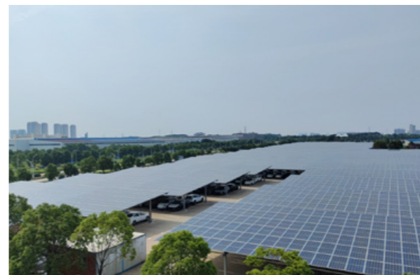
● 旗下东风商用车有限公司一期光伏发电项目
